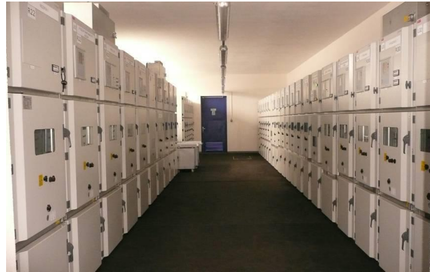
Pohľad na VN rozvádzač
